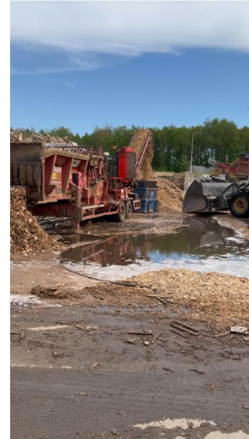
Stofhinder door een houtshredder. Tijdens de controle geen stofverspreiding waargenomen
