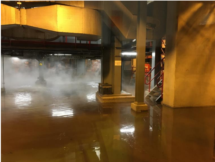
Ketellekkage en bluswater
