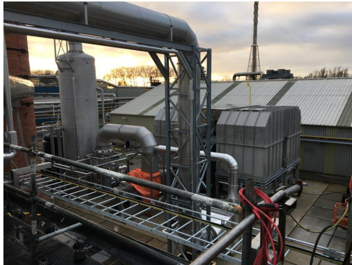
RTO voor de verbranding van emissie (geur)
